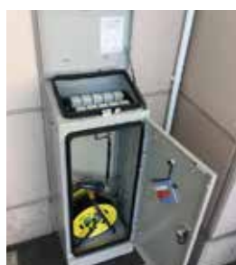
非常用コンセントボックス
