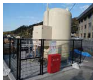
災害バルク貯槽 （本庁舎と中央公民館）
