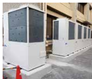
電源自立型 GHP （中央公民館）
