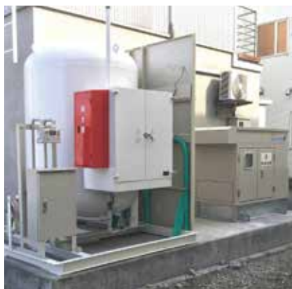
災害バルク貯槽と非常用発電機
