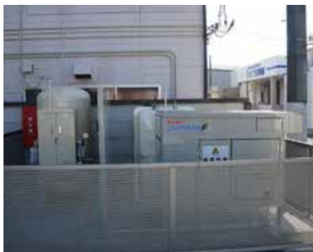
災害バルク貯槽と非常用発電機
