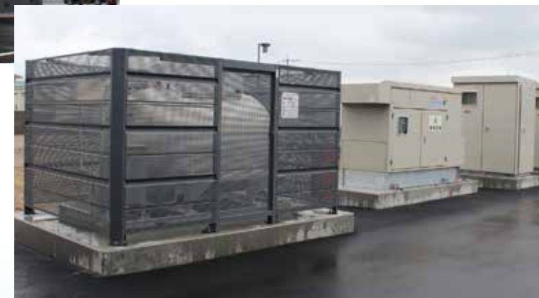
災害バルク貯槽と非常用発電機
