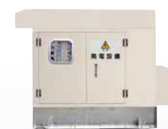
非常用発電機
