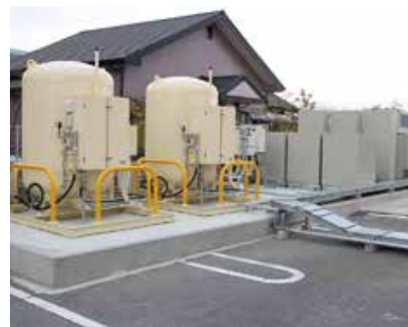
災害バルク貯槽と非常用発電機
