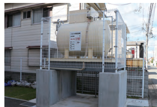
水害対策でかさ上げたバULK貯槽
