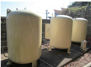
災害バルク貯槽
