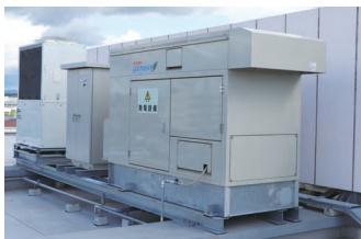
屋上に設置したGHPとLPガス非常用発電機
