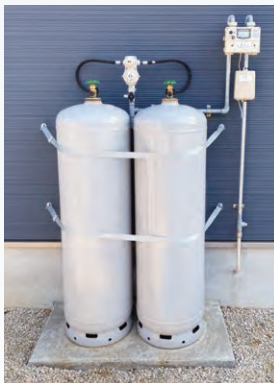
LPガスの軒下在庫
