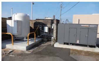
バルク貯槽+非常用LPガス発電機
