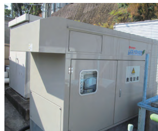
非常用LPガス発電機
