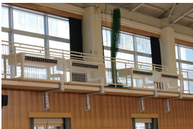
体育館内室内機
