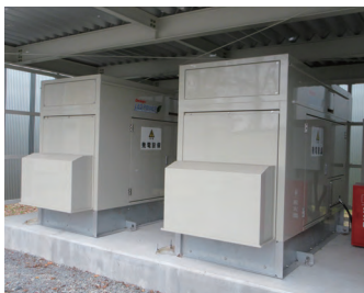
非常用LPガス発電機
