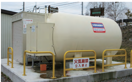
災害バルク貯槽
