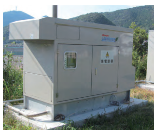
非常用LPガス発電機
