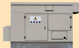
非常用発電機
