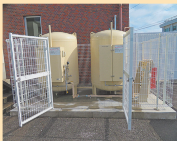
災害バルク貯槽
