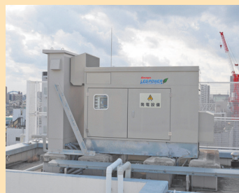
非常用発電機
