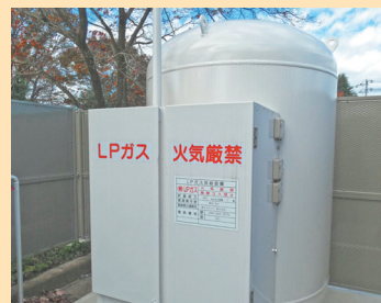
災害バルク貯槽
