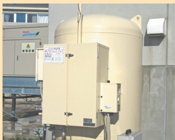
災害バルク貯槽
