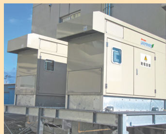
非常用発電機
