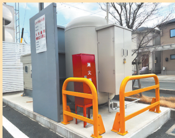
災害バルク貯槽
