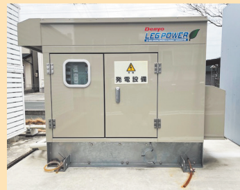
非常用発電機
