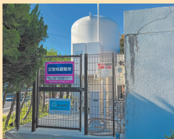
災害バルク貯槽
