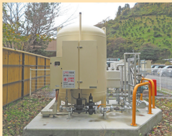
災害バルク貯槽
