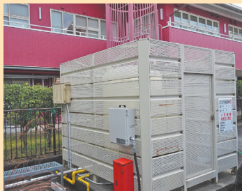
災害バルク貯槽
