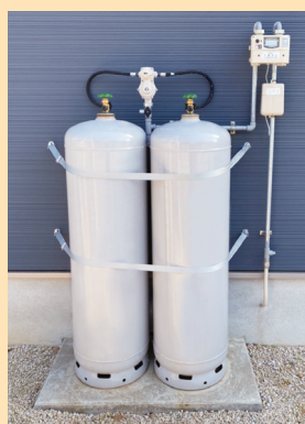
LPガスの軒下在庫
