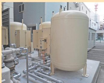
災害バルク貯槽
